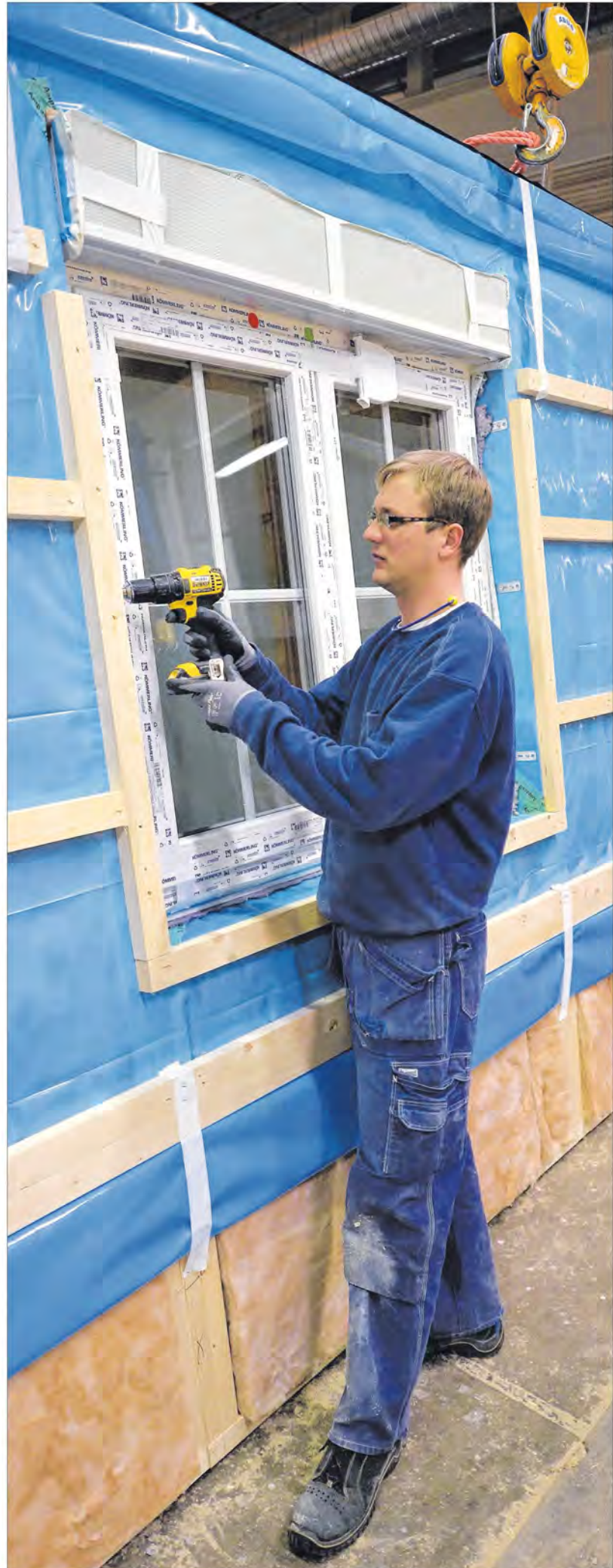
Rene Zinn (33) baut bei Scanhaus Marlow Fenster in die Wand eines Fertighauses. 600 Häuser entstehen so jährlich.
